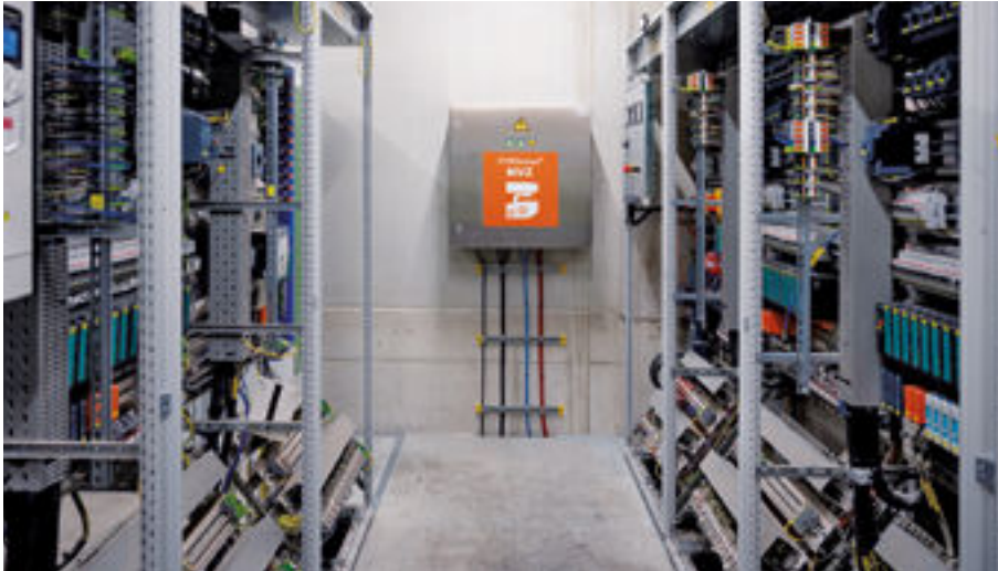
Orglmeister liefert die gesamte Systemtechnik zur sicheren Überwachung, die in einem kleinen Schaltschrank im elektrischen Betriebsraum der Halle untergebracht ist
